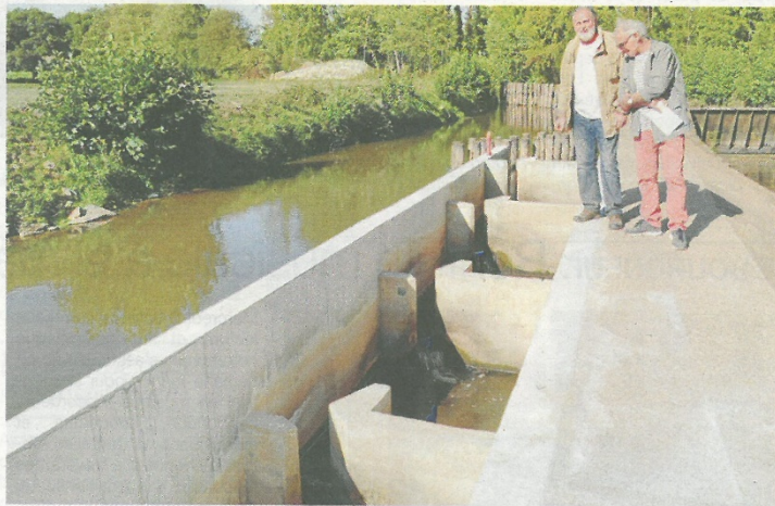
La passe à poisson à bassins successifs au Bas Coudray aura coûté plus de 170 000 euros. Elle permet au moulin de toujours être alimenté en eau.
